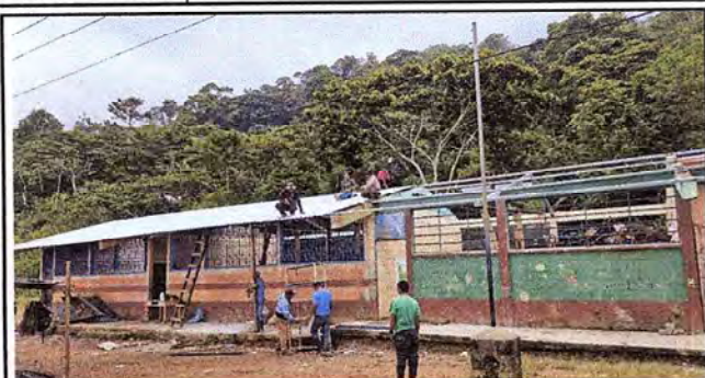
Foto 1: Colocando las laminas del techo deteriorado de 3 aulas, bodega y direccion. Puerta en mal estado, agujeros en la pared.
